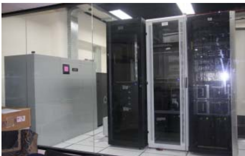
Ruang server pada Data Center
