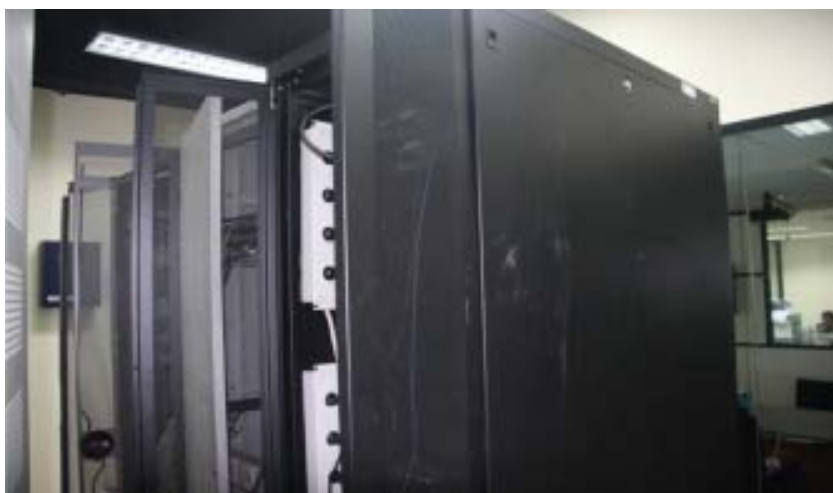
server pada Lab Pengembangan Sistem Informatika
